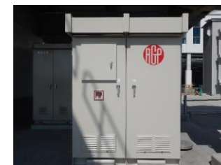
【電力変換装置】
