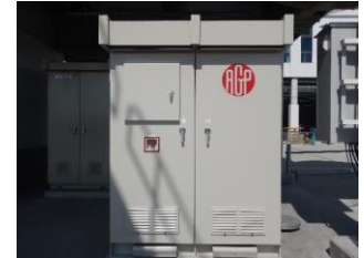
【電力変換装置】 90kVA~180kVA 国内線 # 1~#12 国際線 #53~#58
