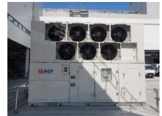
【空調装置】 大型機用 国内線 # 7~#10
