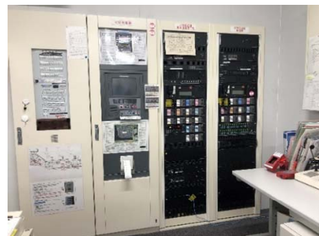
防災センターの総合操作盤
